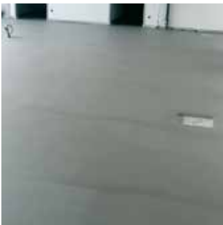
Glanzgradunterschiede in der Versiegelung
