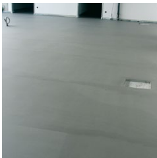
Glanzgradunterschiede in der Versiegelung
