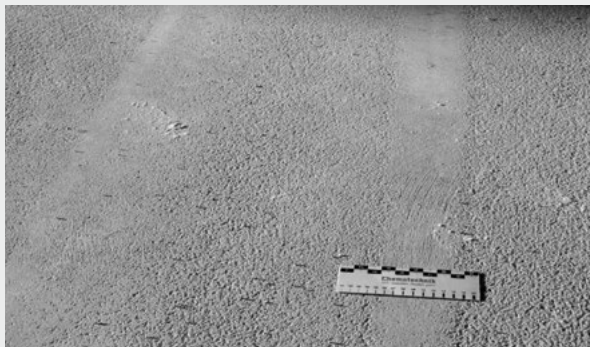
Fräs-/Strahlbild ungeeignet: Reste von Feinmörtel, kein Korngefüge
