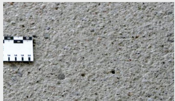
Fräs-/Strahlbild ungeeignet: Reste von Feinmörtel, kein Korngefüge
