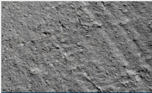
Fräs-/Strahlbild ungeeignet: Reste von Zementschalen
