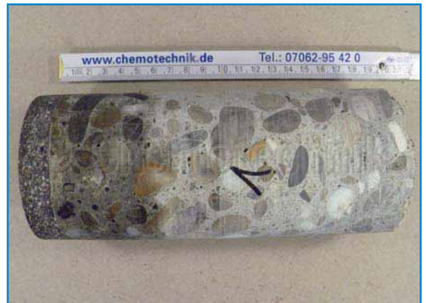
Stark verölter Beton unter Magnesiastrich
