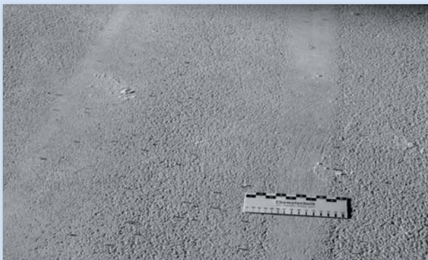
Fräs-/Strahlbild ungeeignet: Reste von Feinmörtel, kein Korngefüge
