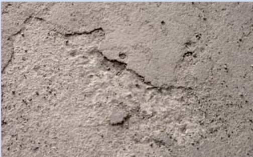
Untergrund ungeeignet: ablösbare Mörtelschichten abzutragen
