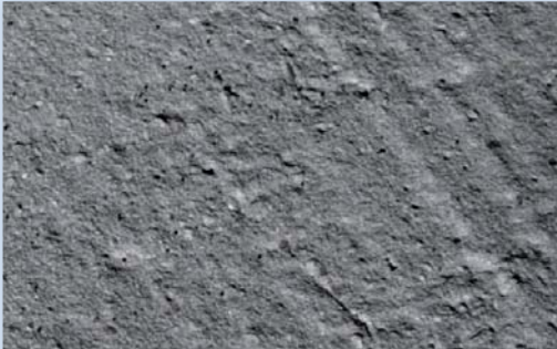
Fräs-/Strahlbild ungeeignet: Reste von Zementschalen
