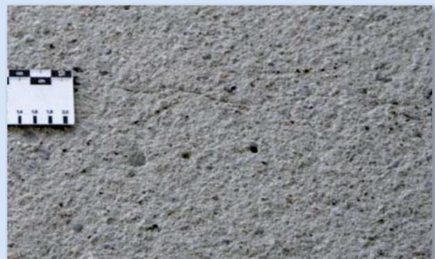
Fräs-/Strahlbild ungeeignet: Reste von Feinmörtel, kein Korngefüge
