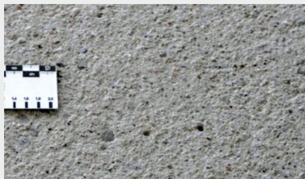
Fräs-/Strahlbild ungeeignet: Reste von Feinmörtel, kein Korngefüge
