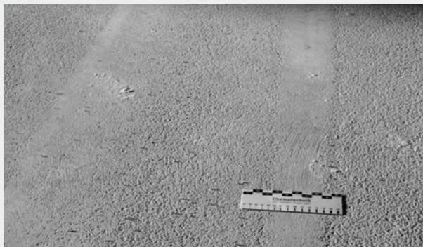
Fräs-/Strahlbild ungeeignet: Reste von Feinmörtel, kein Korngefüge
